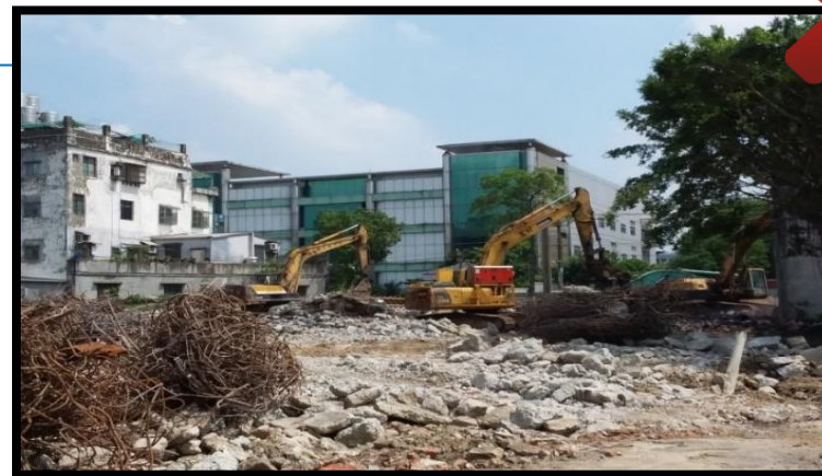
第一級營建工地未採行灑水及結構體包覆塵網(缺失記點10點)
