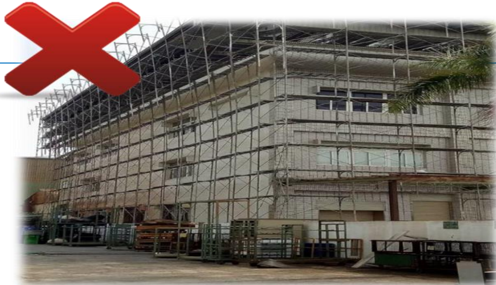
結構體無設置防制設施 (缺失記點10點)
