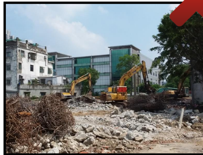
第一級營建工地 未採行灑水及結構體包覆塵網 (缺失記點10點)
