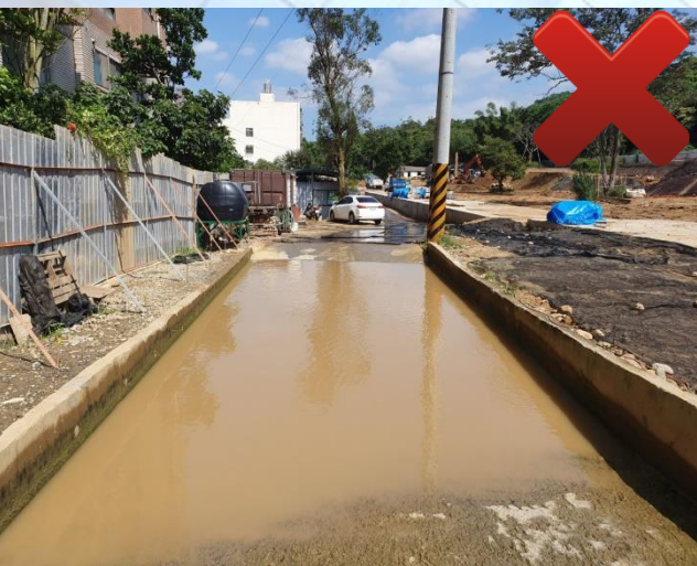
未設置洗車設備
