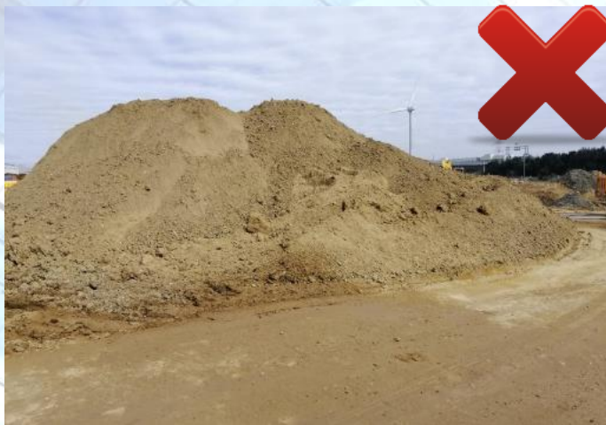
未覆蓋防塵網
