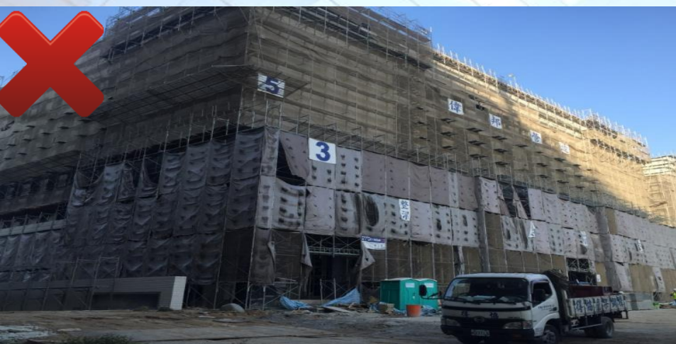
防塵布、防塵網破損
