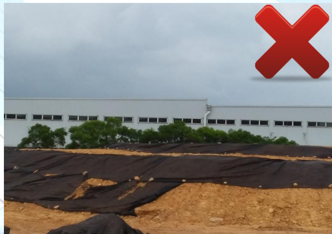
未完全覆蓋防塵網或布，部分裸露
