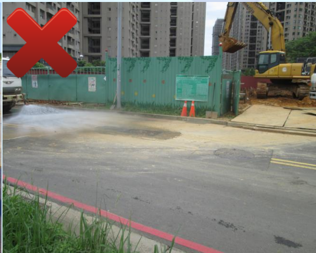
未設置洗車設備
