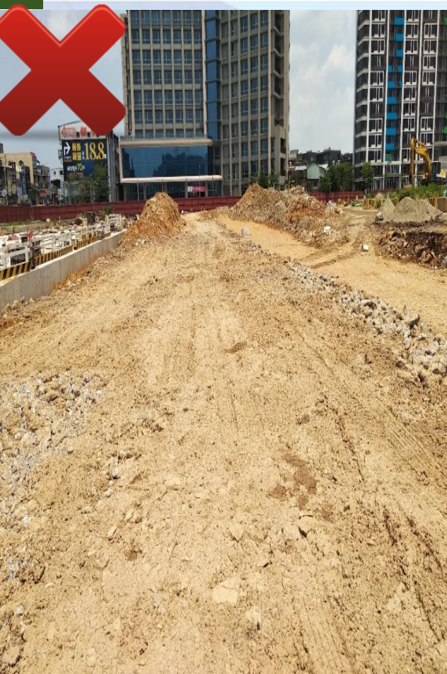
裸露地表 未設置防制措施
