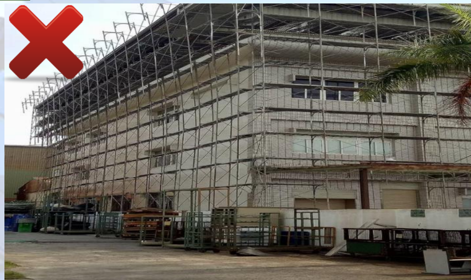
未設置防制措施
