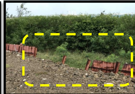
圍籬未涵蓋全工區
