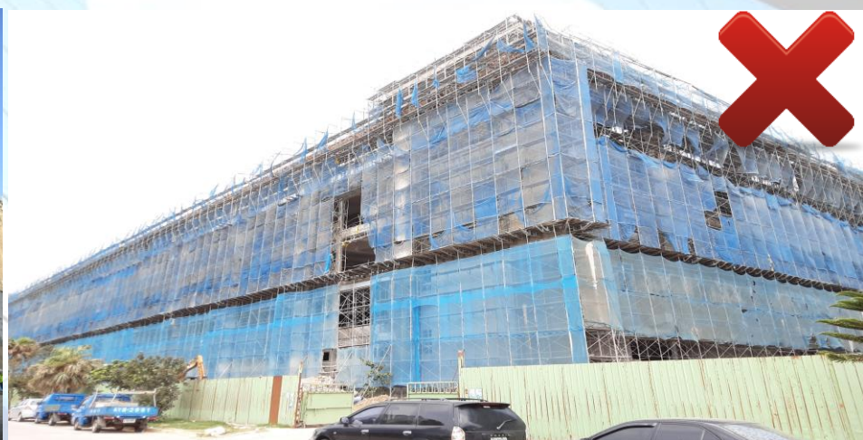
防塵布、防塵網破損
