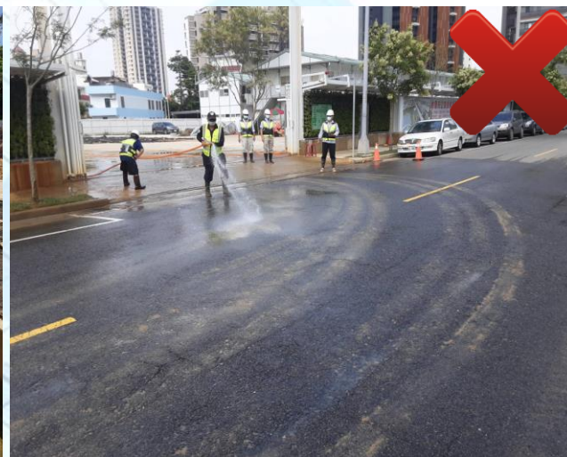
未有效清洗造成路面污染
