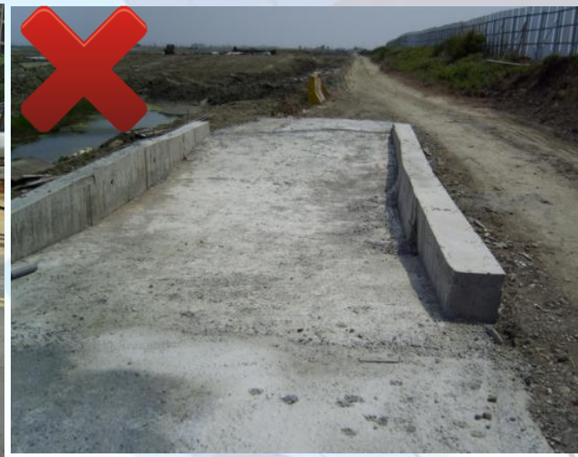
未設置洗車設備
