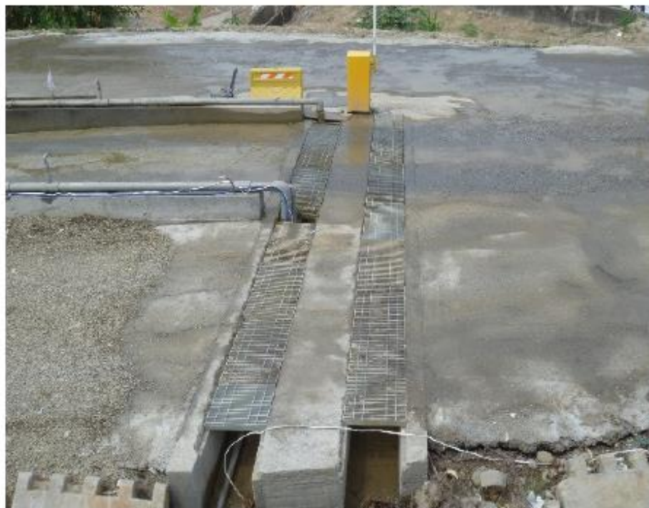
(G) 洗車廢水收集設施 (一)
