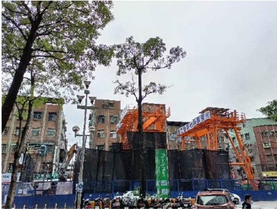
(C) 半阻隔式圍籬（捷運工程）
