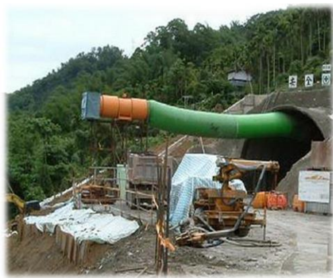
(A) 排放管道集塵設備
