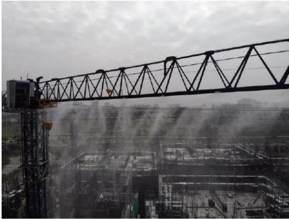
(E) 結構體設置自動灑水設備
