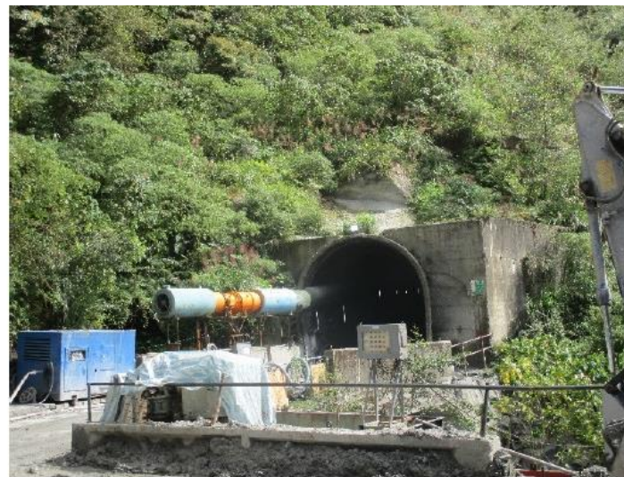
(B) 排放管道集塵設備
