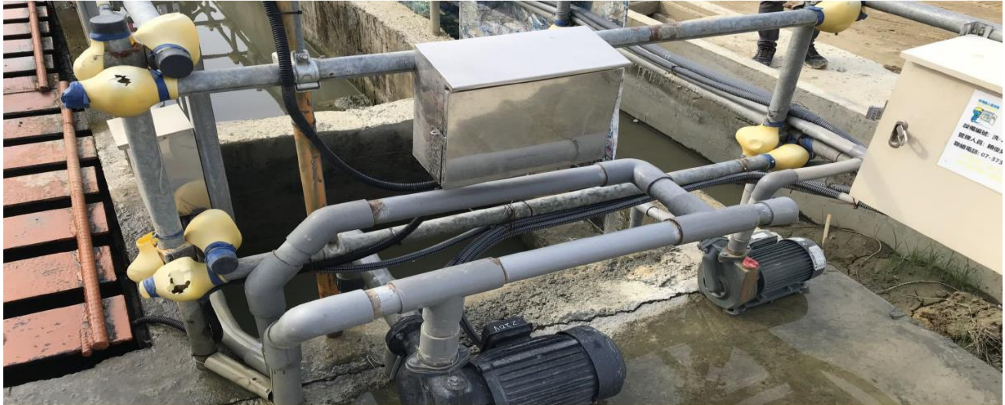
屬第18條一定施工規模之營建工程使用洗車設備，未設置監測儀表 (水表或電表、水壓表)。
