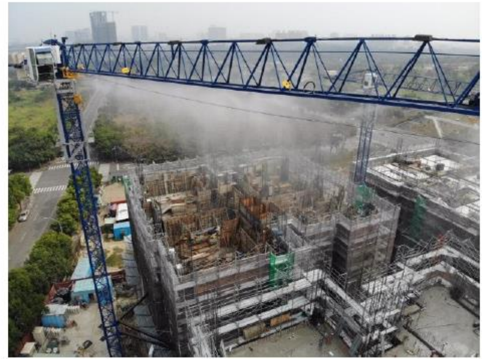
(F) 結構體設置自動灑水設備
